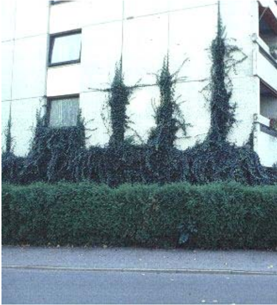
Vorsicht Bauschäden: Efeu am Plattenbau
